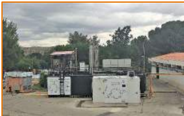
Butarque (Madrid) Fangs depuradora 5 GWh/a Xarxa i ús vehicular
